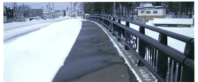
ロードヒーティング融雪状況
